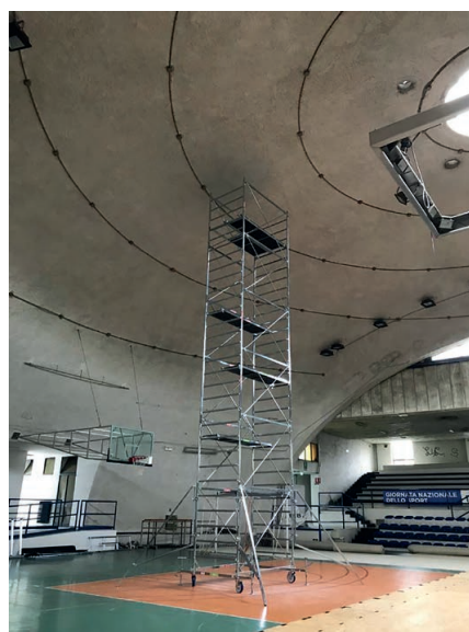
Le operazioni di verifica sui distaccamenti di intonaco verificatisi al PalaCesari
